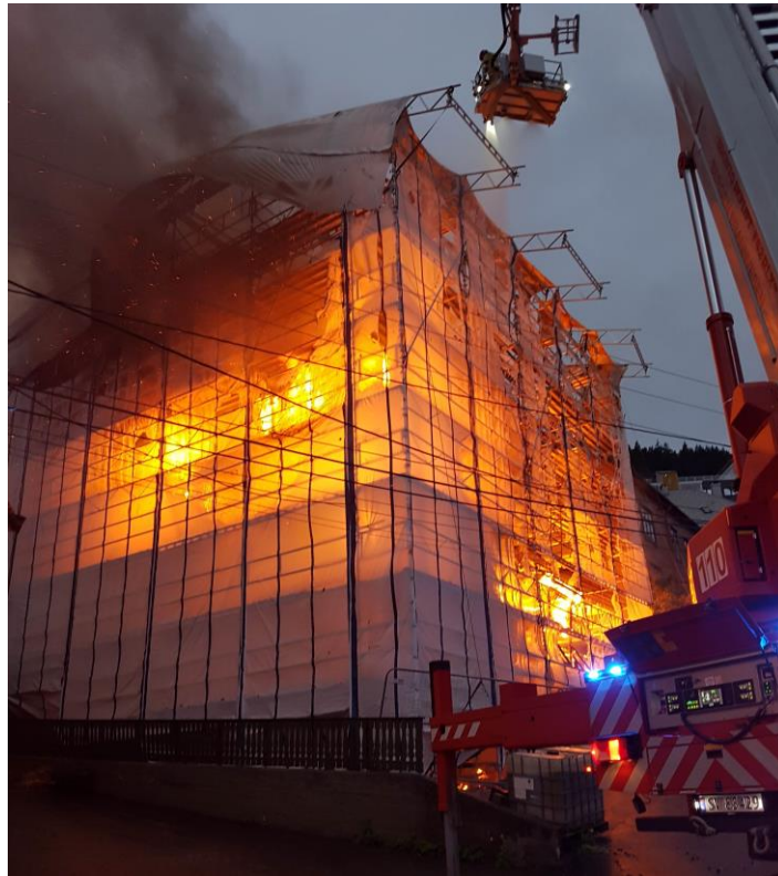
Figur 4-1: Bilde fra en brann i et tildekket bygg under totalrehabilitering. Bildet viser at store deler av tildekkingen er intakt til tross for kraftig brannutvikling i bygget. Foto: Bergen brannvesen.
