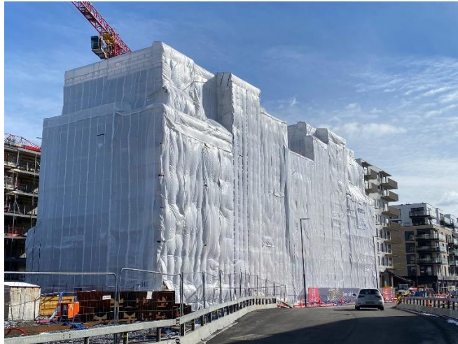
Figur 2-1: Eksempel på bygg under oppføring der store deler av fasaden er tildekket. Foto: RISE Fire Research.
